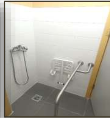
Εικόνα 177. Ντουζιέρα (Ειδικό Νηπιαγωγείο Δράμας)
