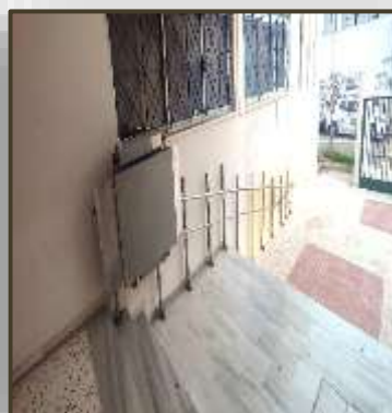
Εικόνα 96. Αναβατόριο κλίμακας με πλατφόρμα (6 ο ΓΕ.Λ. Ιλίου)
