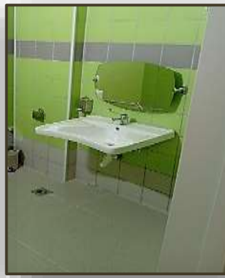
Εικόνα 179. Τουαλέτα (10° Δημοτικό σχολείο Κοζάνης)
