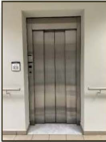
Εικόνα 78. Ανεγκυστήρας (Ε.Ε.Ε.ΕΚ. Ηρακλείου Αττικής)
