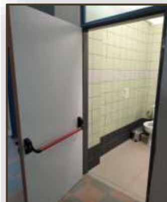
Εικόνα 183. Πόρτα με μπάρα (3° Δημοτικό σχολείο Αμυνταίου Φλώρινας)
