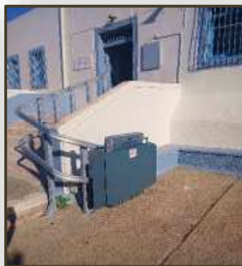
Εικόνα 95. Αναβατόριο κλίμακας με πλατφόρμα (3 ο Γυμνάσιο Καλύμνου)
