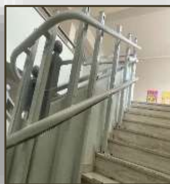
Εικόνα 92. Μηχανισμός για αναβατόριο κλίμακας (3ο Δημοτικό σχολείο Ηγουμενίσσας)
