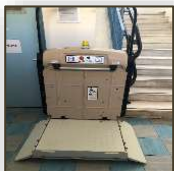
Εικόνα 98. Αναβατόριο (Ειδικό Δημοτικό σχολείο Ερμούπολης)
